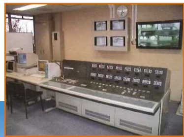
津波・高潮防災ステーション (牧之原市役所相良庁舎)
