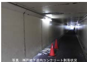
写真 神戸地下道内コンクリート剥落状況
