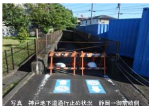
写真 神戸地下道通行止め状況 静岡一御前崎側
