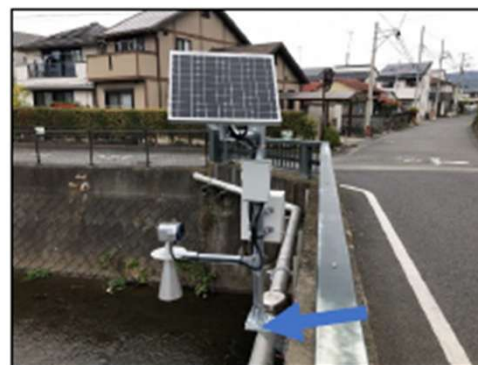
水位計設置イメージ
