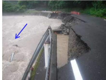
県道相俣岡部線の道路決壊 (藤枝市岡部町岡部)
