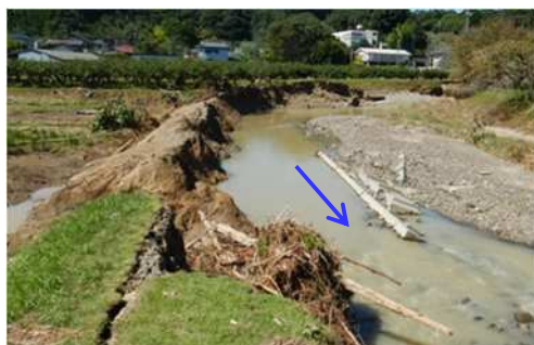
二級河川敷地川の破堤 (磐田市敷地)
