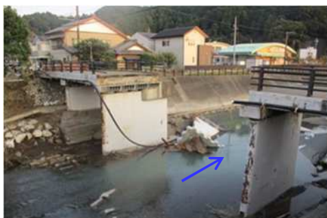
橋梁（嘯月橋）の落橋 (浜松市天竜区二俣町)
