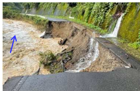
県道蔵田島田線の道路決壊 (島田市伊久美)
