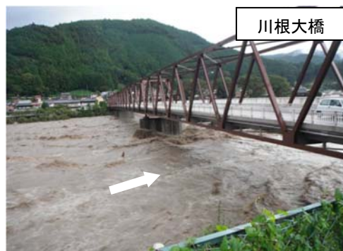
写真 2-8 平成 23 年 9 月台風 15 号洪水の状況
