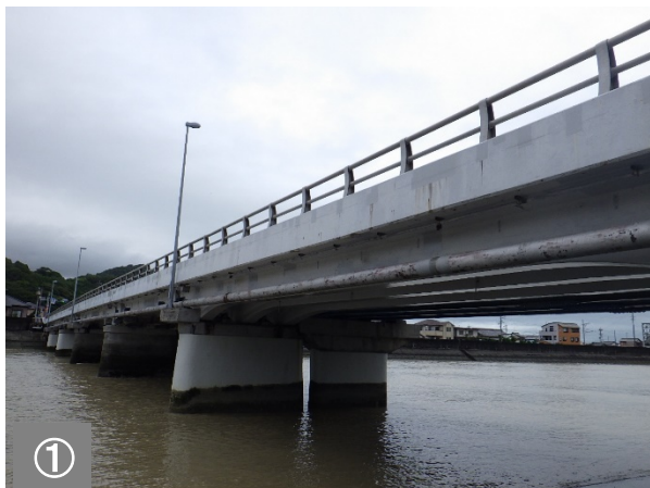
① 当目大橋の上部工、下部工、各種装置について補強・橋梁補修工事を行います。
